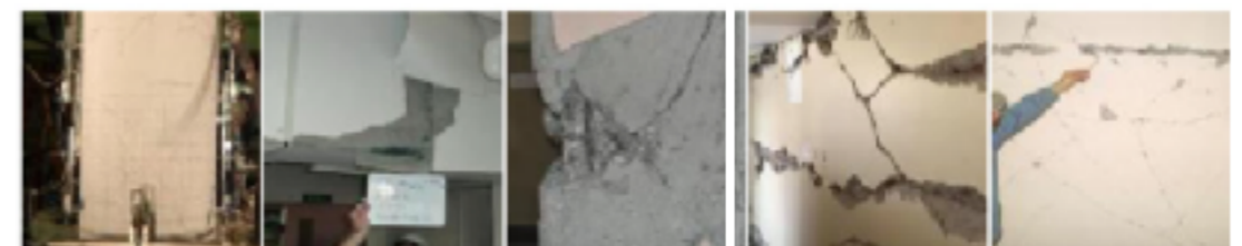
(d) Combined damage
