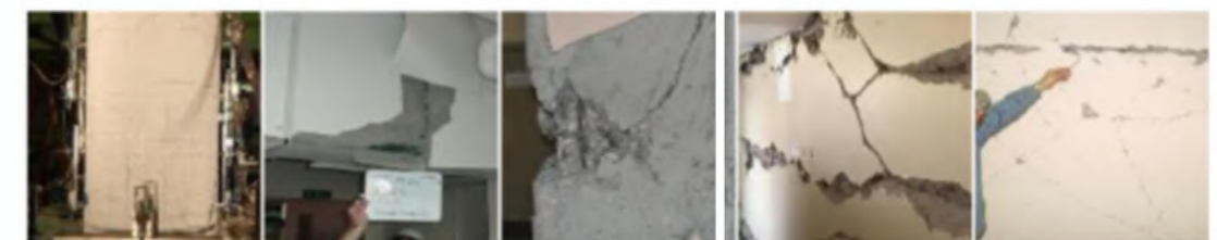
(d) Combined damage
